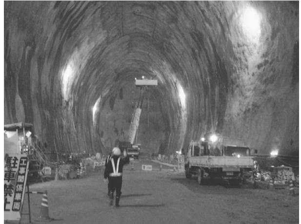
図4 LPガス地下備蓄基地の建設現場 (愛媛県今治市, 2008年12月撮影)
